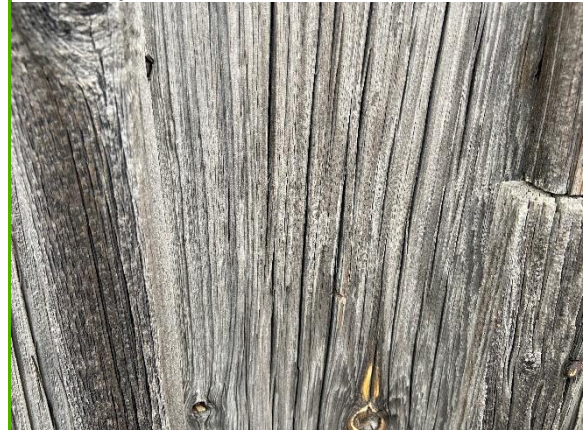
Etenkin eteläsivuilla julkisivulaudoitus halkeilee
