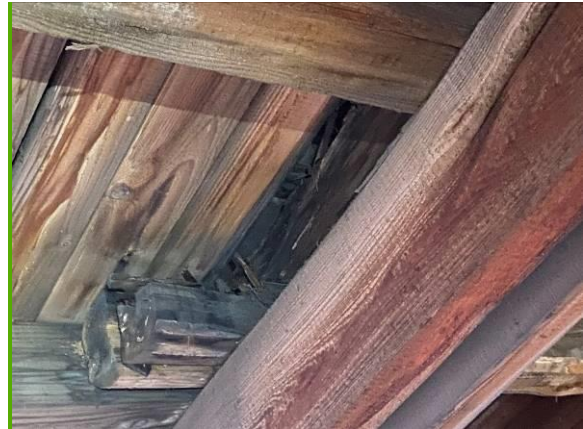
Vesikatto vuotanut sisään lahottaen alusruoteita ja orsia
