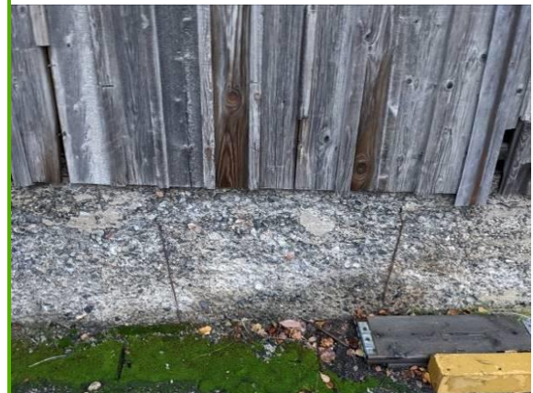
Sokkeli rapautunut laaja-alaisesti ja voimakkaasti läpi rakenteen, ruostuneita teräksiä pinnalla, sammalta vierustalla
